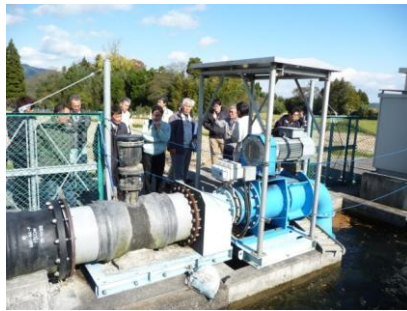
マイクロ水力発電所 (竹田市)
